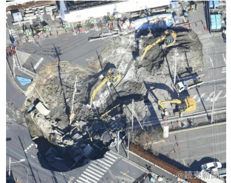
八潮市の道路陥没
